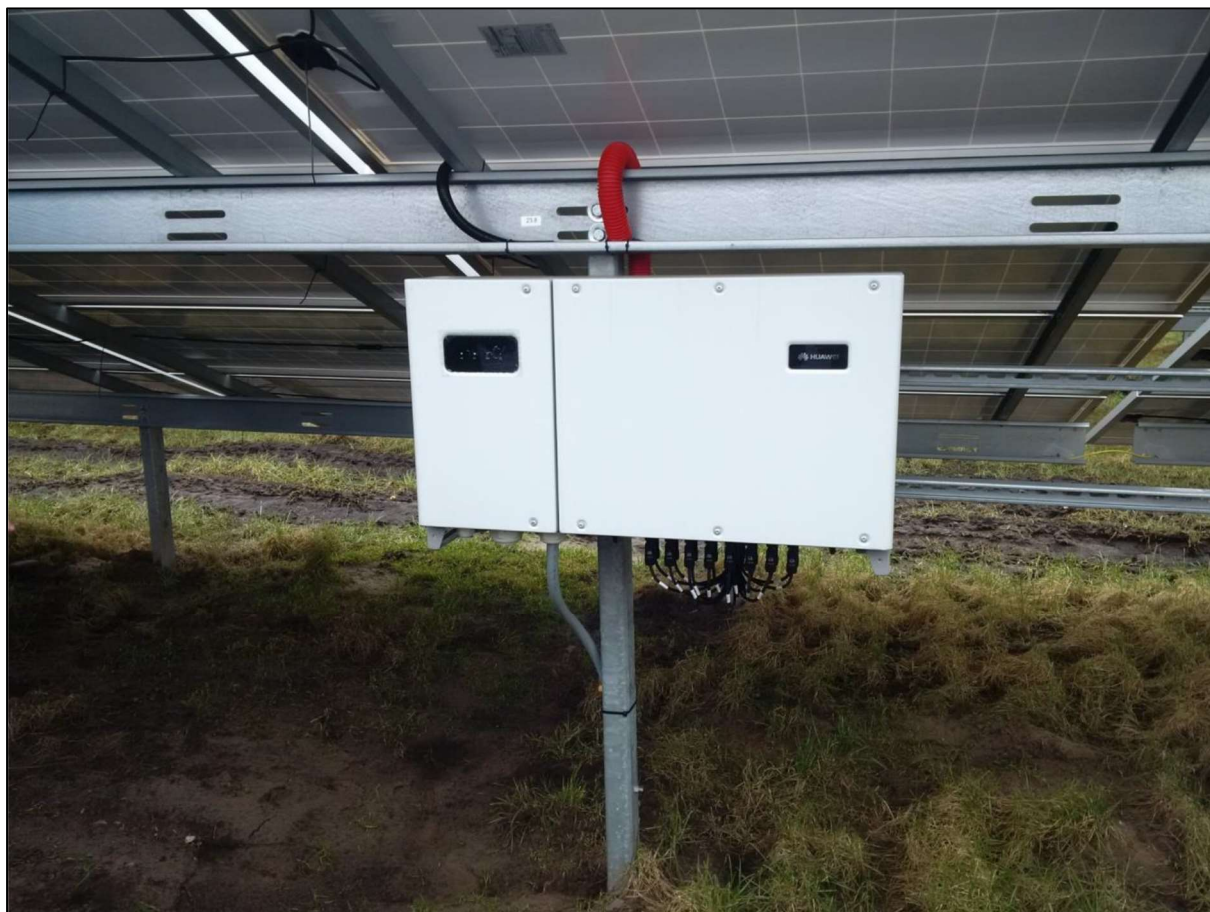
Rysunek 15 Przykład inwertera o mocy 42 kW zamocowanego na konstrukcji nośnej.
