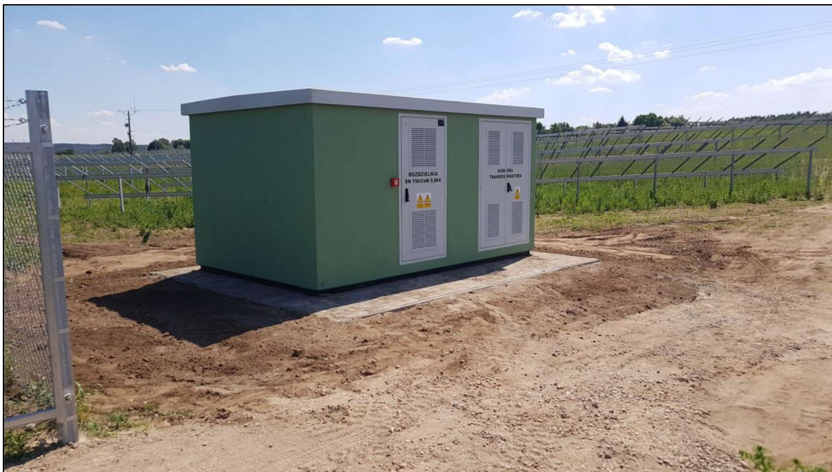
Rysunek 17 Przykład stacji trafo.
