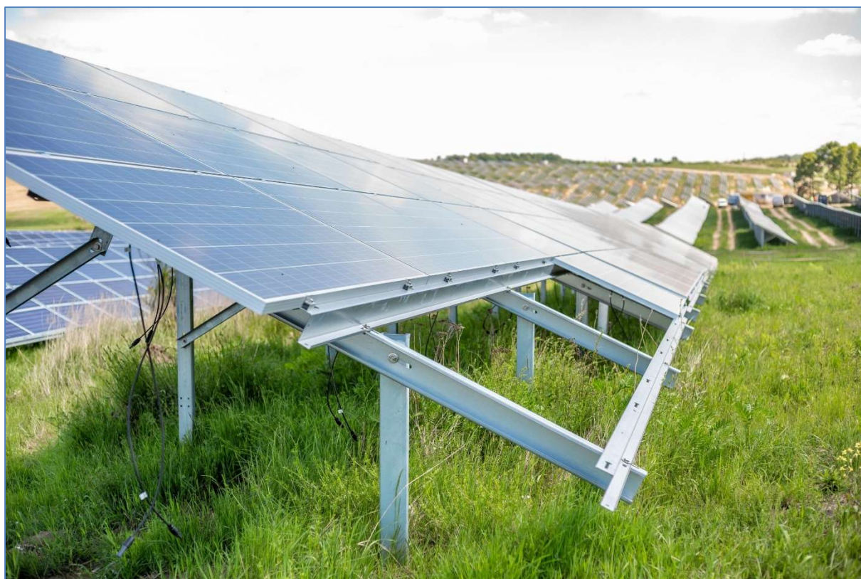
Rysunek 35 Przykładowa konstrukcja stalowa- stelaż pod panele fotowoltaiczne.
