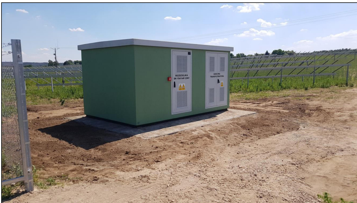
Rysunek 17. Przykład budynku technicznego
