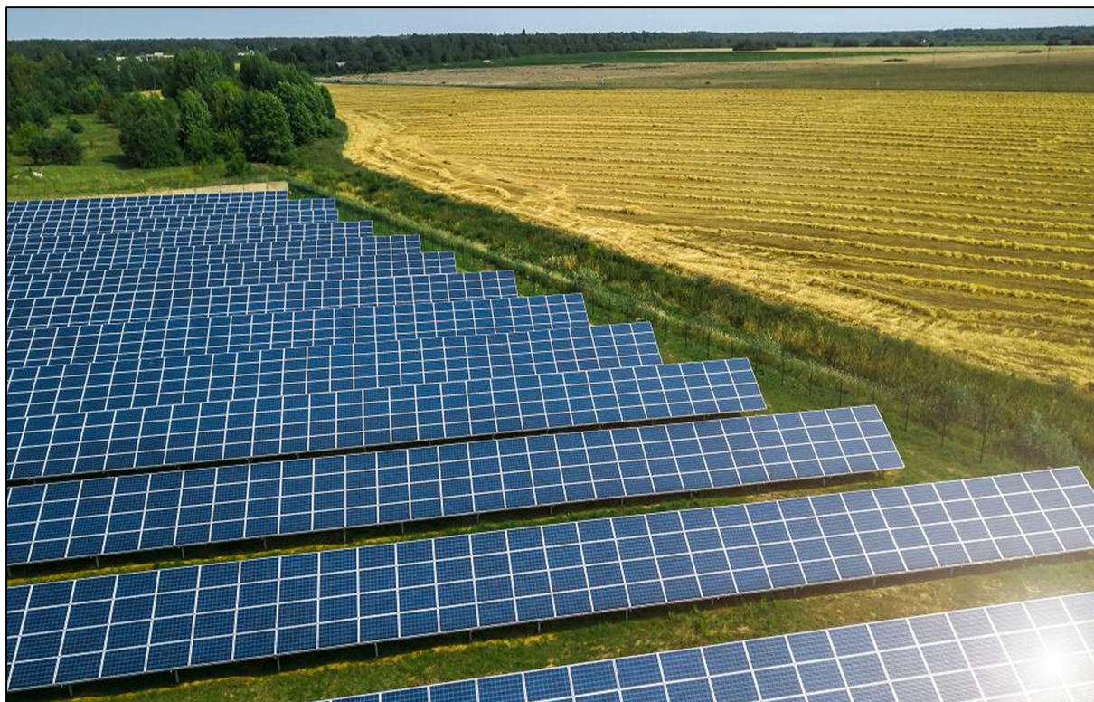
Rysunek 19. Przykładowa naziemna instalacja -Elektrownia fotowoltaiczna.
