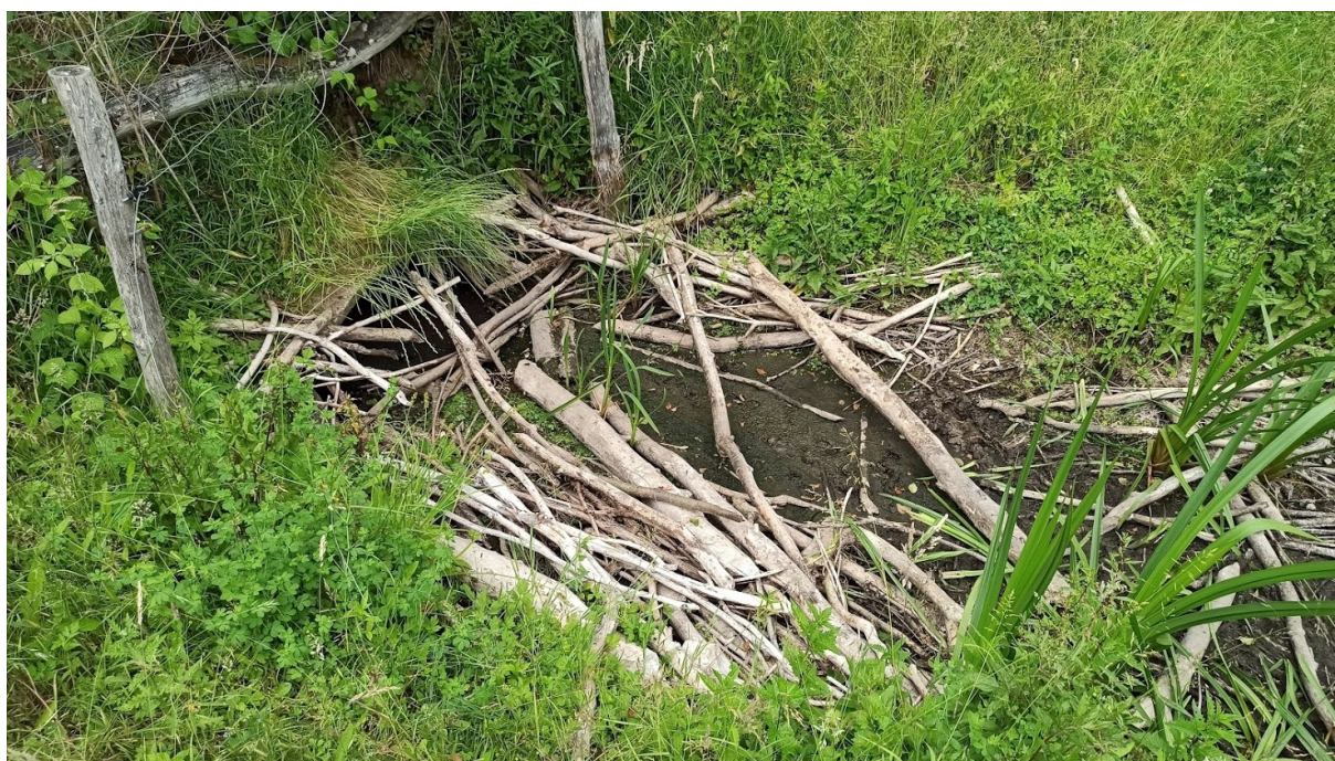
Fot. 15. Ślady działalności bobrów w sąsiedztwie przepustu.
