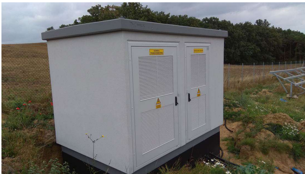
Widok i sposób posadowienia typowego kontenera stacji transformatorowej.
