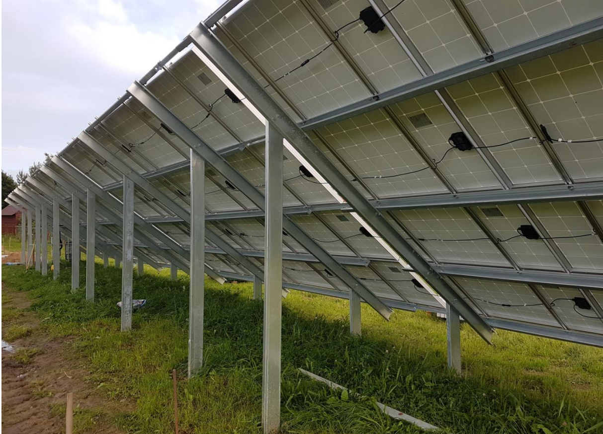
Zdj. 1. Zdjęcie konstrukcji montażowej paneli fotowoltaicznych
