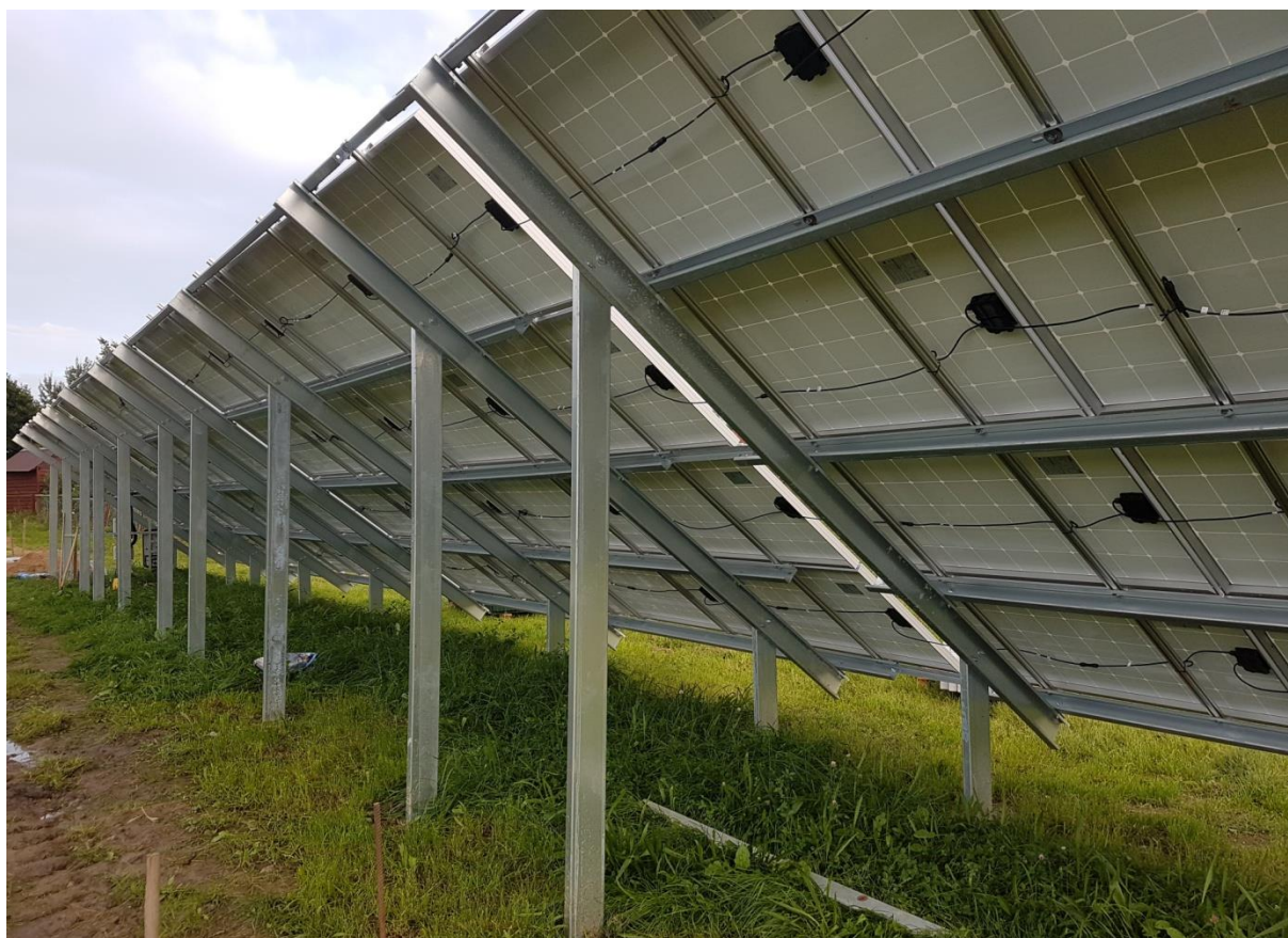
Zdj. 4. Zdjęcie konstrukcji montażowej modułów fotowoltaicznych
